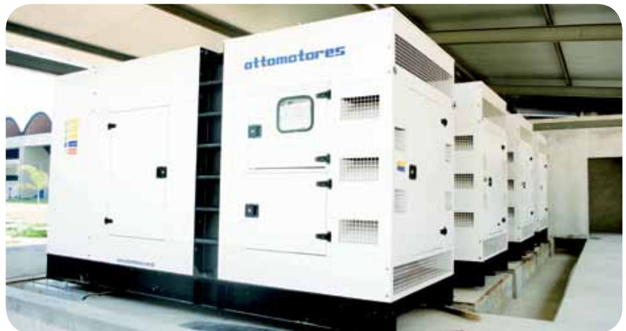
A aquisição dos novos geradores impedirá que haja interrupção no fornecimento de energia elétrica para o campus
